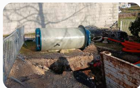
Pompe de relevage des eaux usées Salle des fêtes
